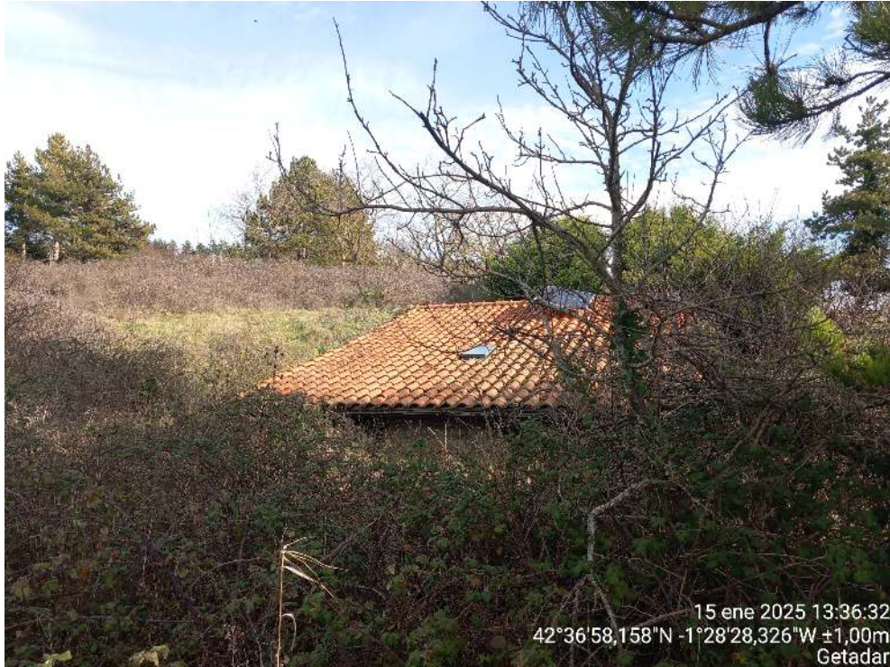
Figura 17: Detalle de construcción con alta peligrosidad inmersa en matorral.
